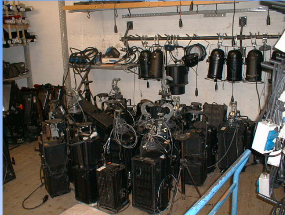
Beleuchtungsanlagen und elektrische Betriebstechnik
